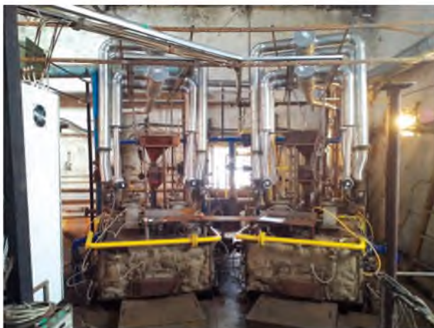
Загальний вигляд установки
