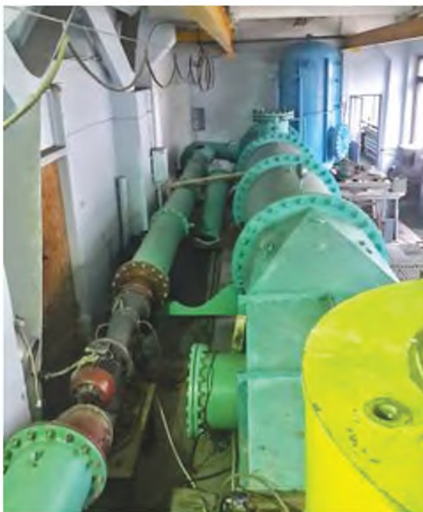
Установка для випробувань мікроГЕС на стенді ЕКС-15
