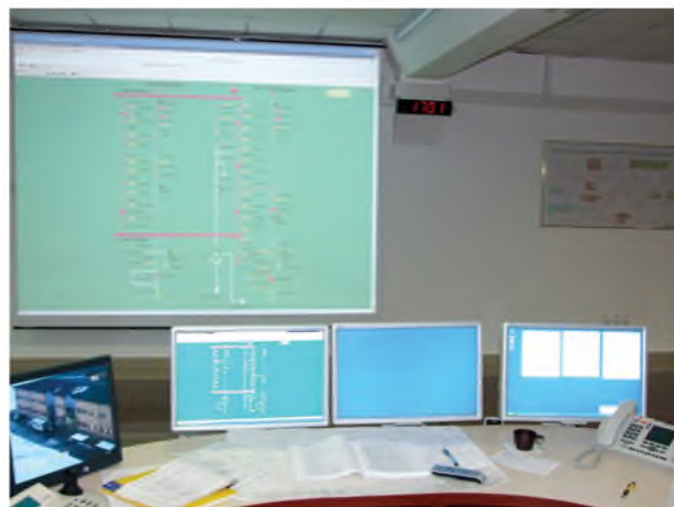
Зал керування підстанції 750 кВ «Київська»
